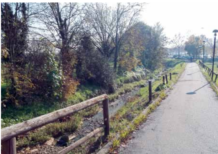
Parapetto pista ciclo-pedonale Torrente Trobbia: uno dei tratti da riqualificare
